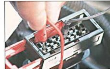
Fig. 6.1. Curto-circuito do chicote do relé duplo para acionamento da bomba elétrica.
