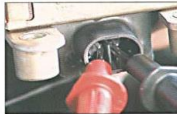
Fig. 3.1. Medida da resistência entre os bornes de baixa tensão (1 e 2) da bobina de ignição A.
