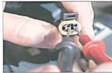
Fig. 1.2. Medida da tensão de alimentação da bomba de combustível.
