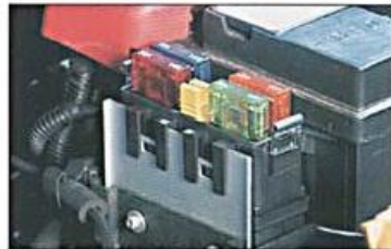
Fig. 2.b. Localização dos fusíveis EFI 30A e IGN 40A: numa chapa de apoio situada do lado esquerdo da bateria.
