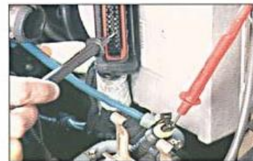
Fig. 3.1. Exemplo de verificação de continuidade no chicote da válvula CANP (entre os bornes 2 da válvula e 22 do MC).
