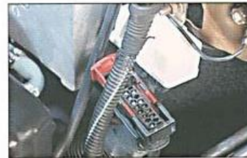
Fig. 6.a. Terminal elétrico do relé duplo desconectado.
